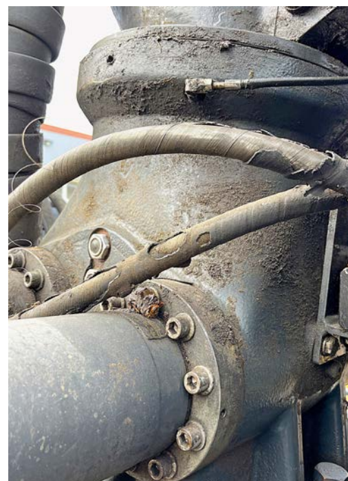
Bild 3b: Hydraulikleitungen mit fehlender Ummantelung (Quelle: KWF e.V.)
