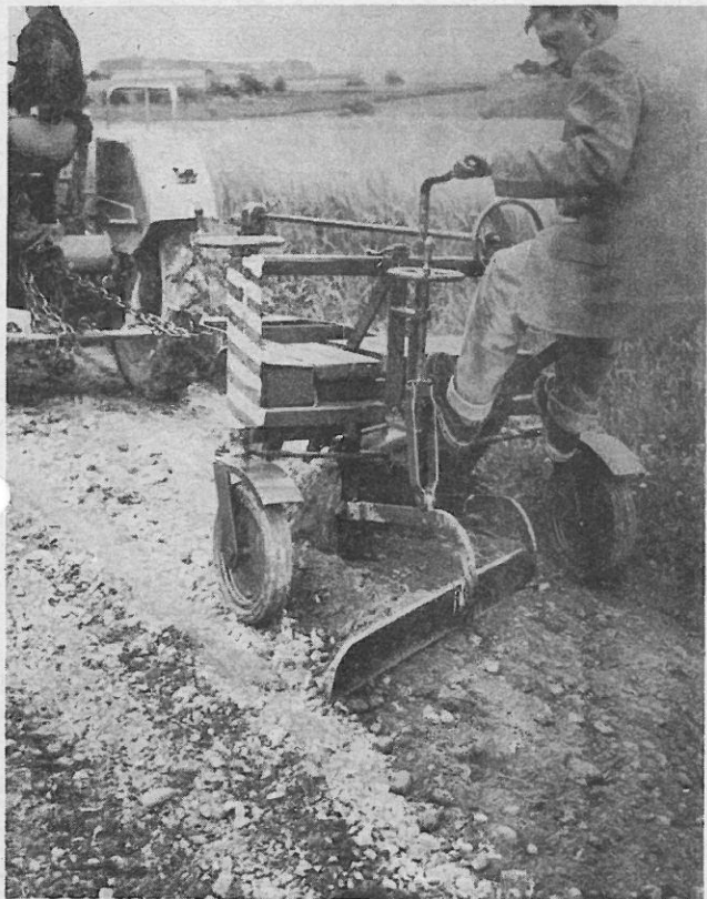
Abb. 20: "Gottwalt'sches Weggerät" im Einsatz. Das rückwärts angebrachte Zusatzschar ebnet das gelöste Material laufend. Hilfsarbeiter sind dabei kaum nötig
