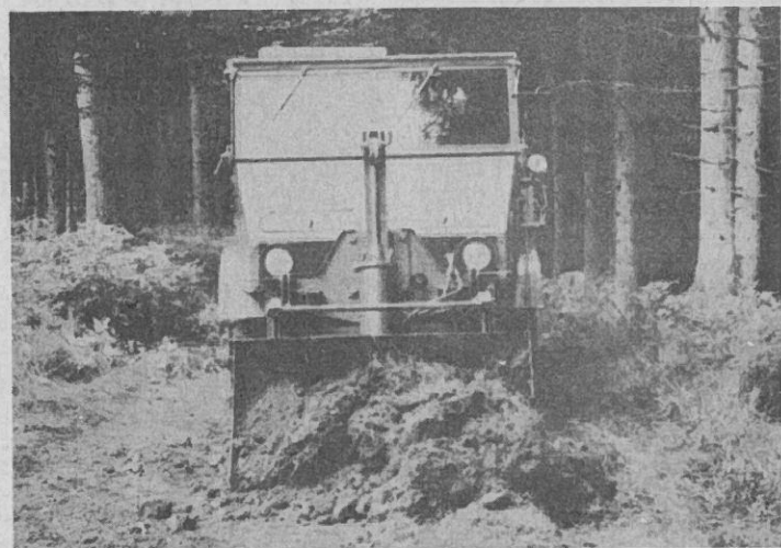
Mit der Transportmulde wird das gelöste organische Material erfaßt und seitwärts in den Bestand abgeladen.
