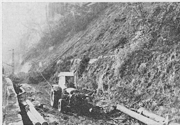
Abb. 5: Drehen des Stammes an der Böschungsmauer durch Vorwärtsfahren des Schleppers und Einziehen des Windeseiles
