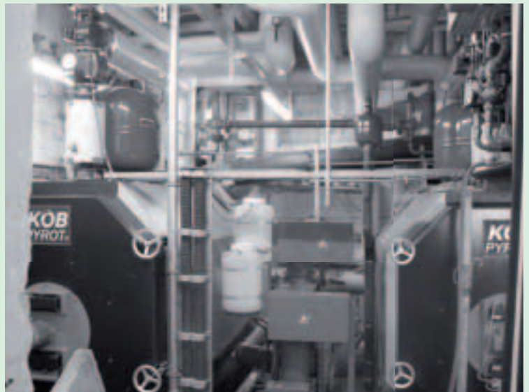
Abb. 2: Blick in das Herz der Heizanlage mit den beiden Kesseln (400 und 540 kW Nennleistung)
